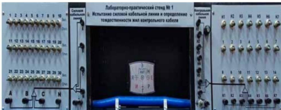
Рис. 4. Стенд «Исследование сопротивления силовой кабельной линии и определение тождественности жил контрольной кабельной линии»
